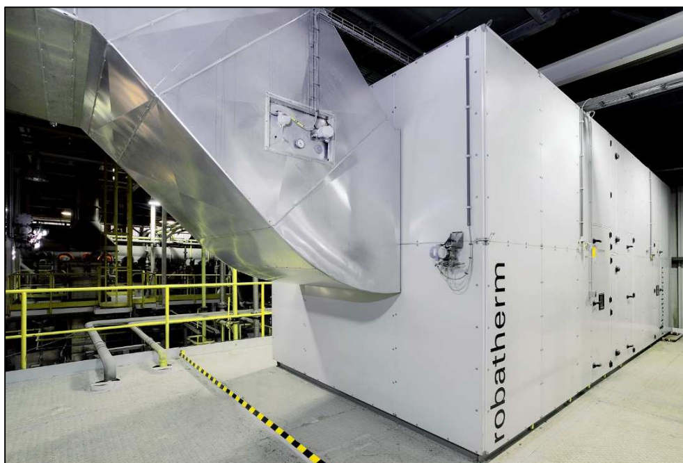
Groupe de ventilation process débit 95.000 m 3 /h (Aspiration air neuf – air recyclé)
