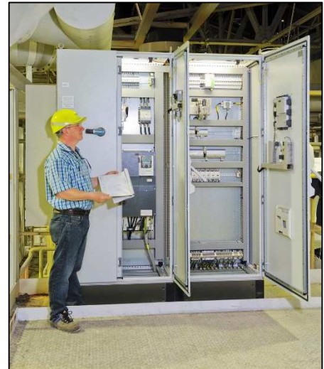
Armoire électrique de conduite de l'installation HVAC (PLC et pupitre opérateur de marque Schneider)
