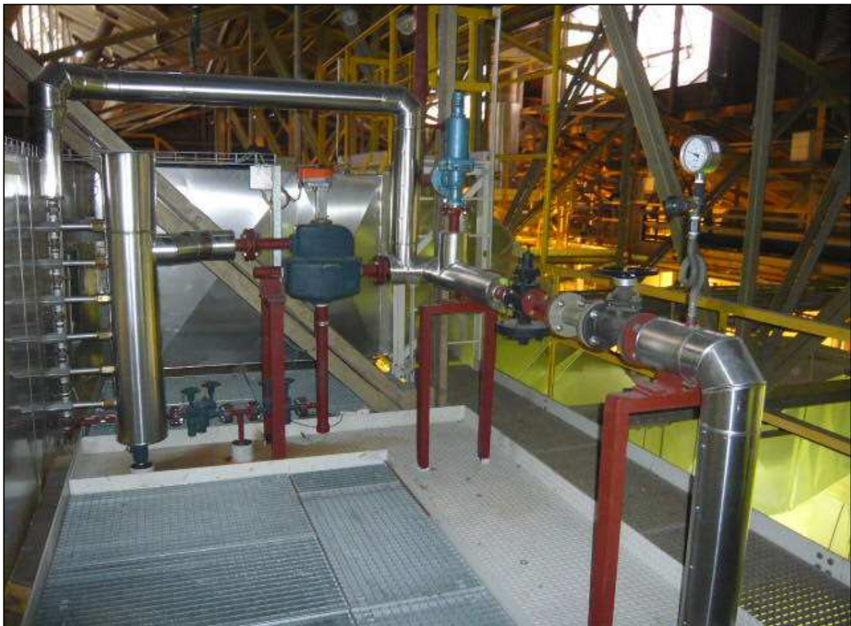
Humidification vapeur – 700 kg/h : panoplie vapeur et rampes préchauffées d'injection de vapeur
