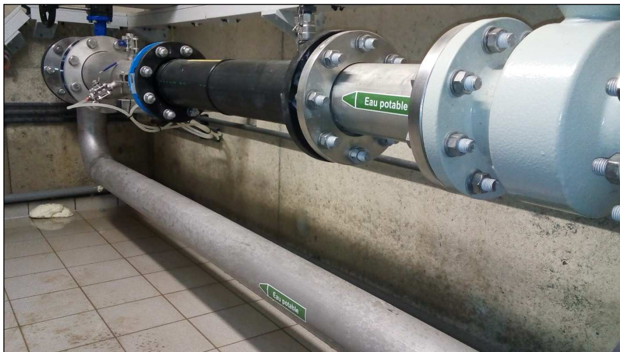
Ligne d'injection : injection de chlore et mélangeur statique
