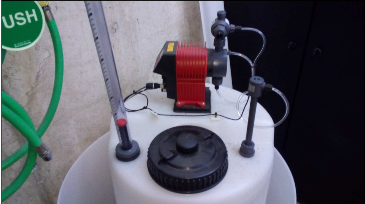
Stockage et pompe d'injection de chlore
