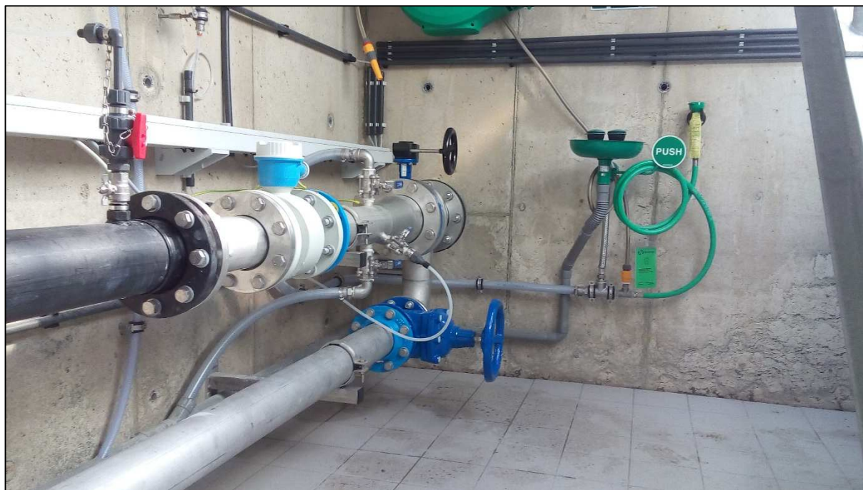
Ligne d'injection : mesure débit et injection de chlore
