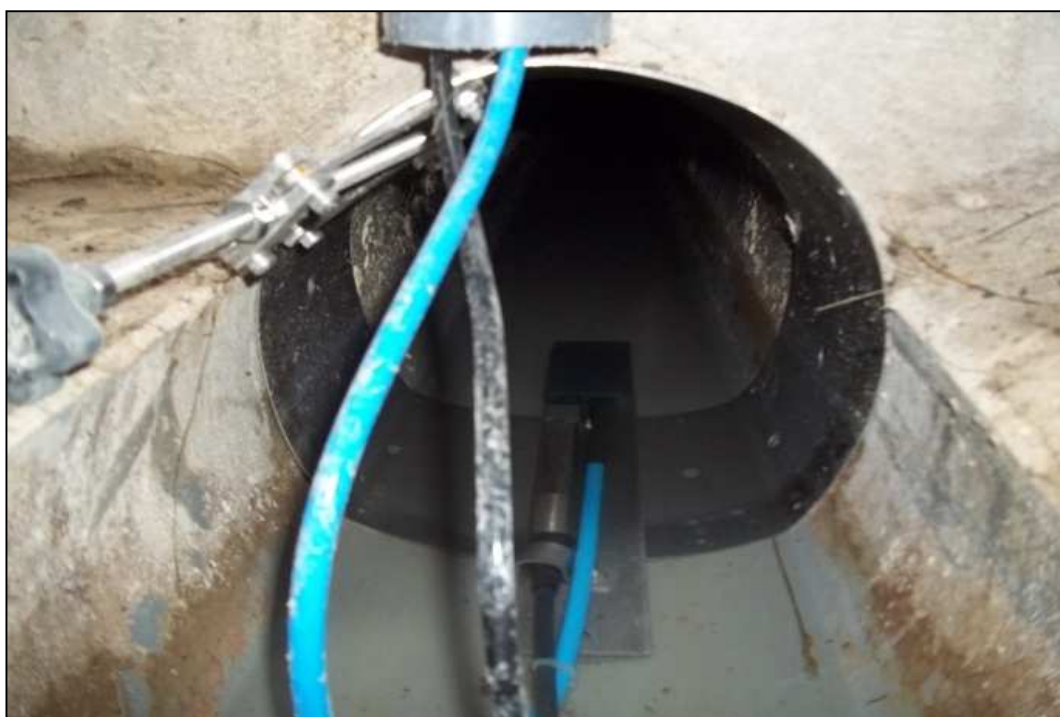
Implantation d'une sonde de mesure de débit
