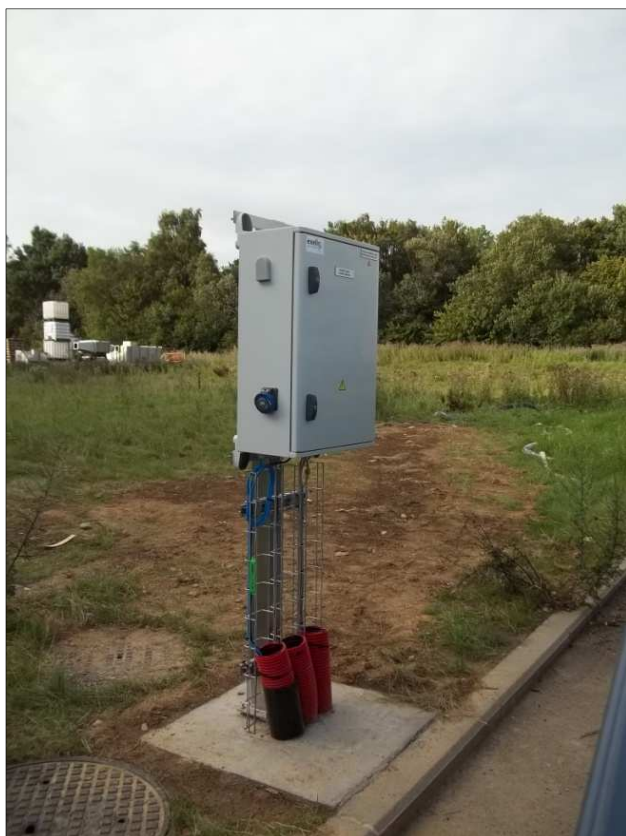
Coffre local de mesure
