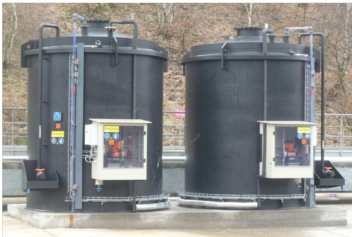
Vue générale des cuves de stockage et de dosage d'H 2 SO 4 97% et de FeCl 3 40%
