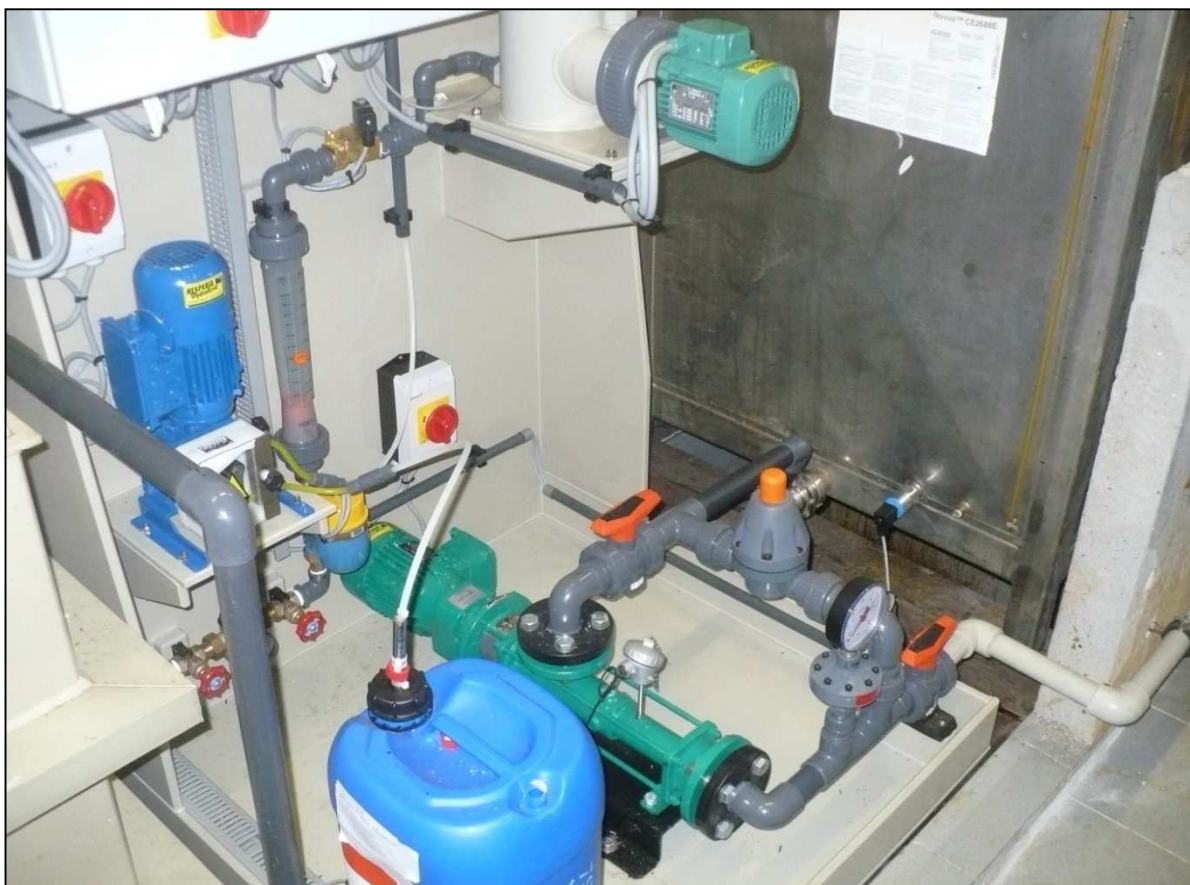
Détail de l'unité de préparation et de dosage de floculant
