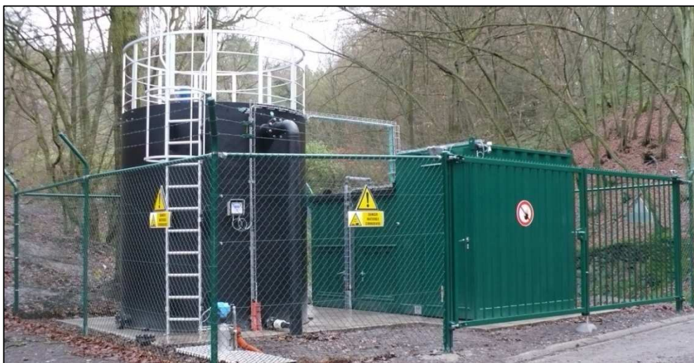
Vue général de la station de neutralisation
