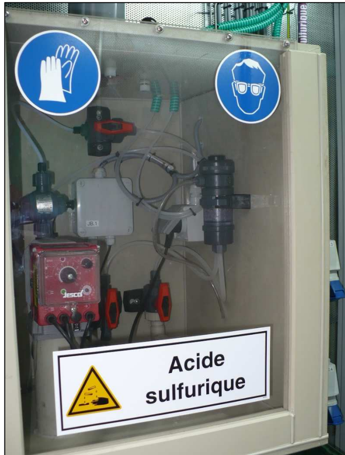
Détail de l'armoire de dosage d'H 2 SO 4 37.5%
