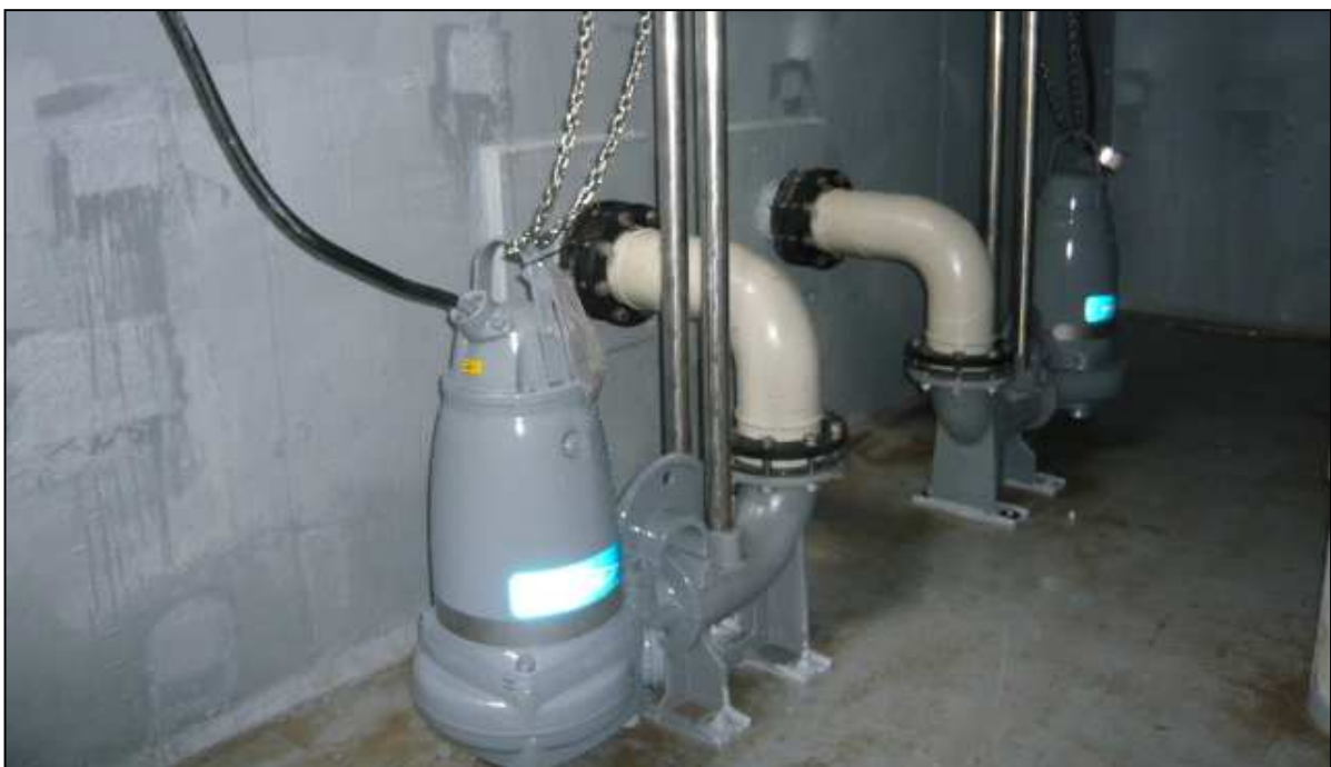
Détail des pompes de recirculation installées dans chaque cuve de neutralisation
