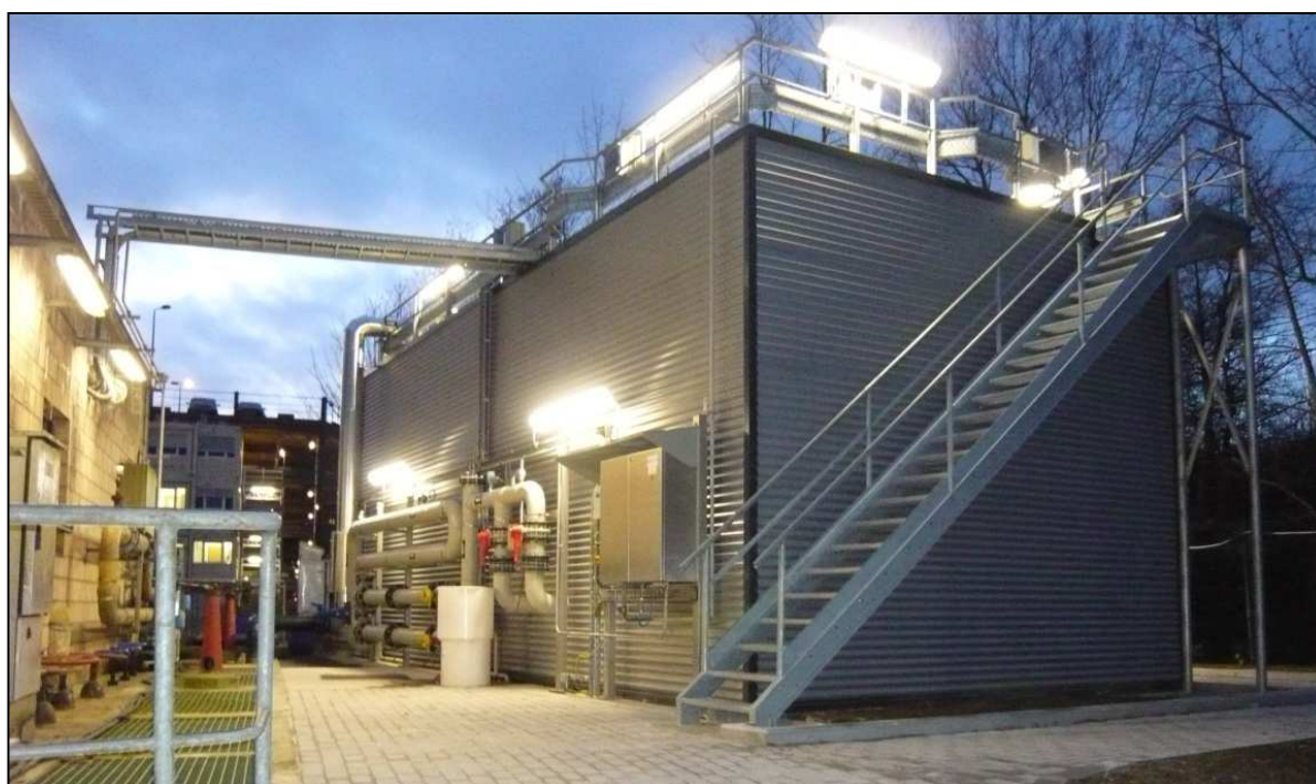
Vue générale de la station de neutralisation : 2 lignes parallèles fonctionnant en alternance
