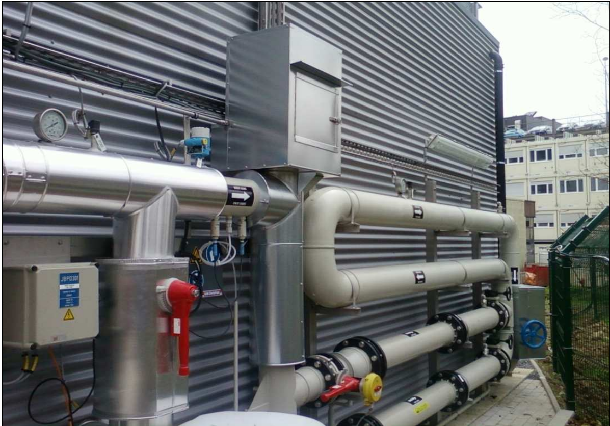
Détail de la boucle d'injection de CO 2 avec 2 sondes de pH pour la régulation du dosage et la tuyauterie sous pression avec mélangeur statique pour assurer la mise en solution du CO 2
