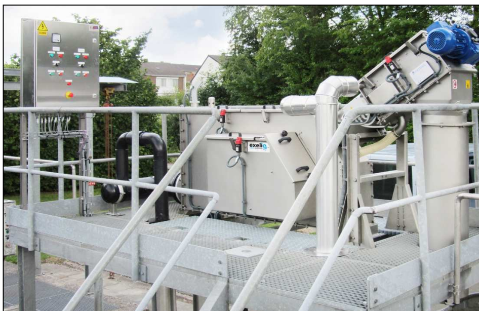
Vue générale du dégrilleur de Saintes
