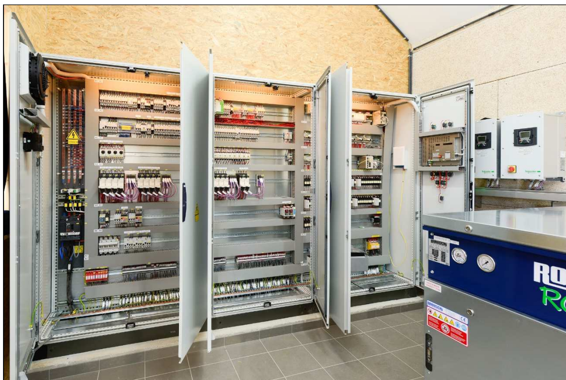
TGBT dans le bâtiment
