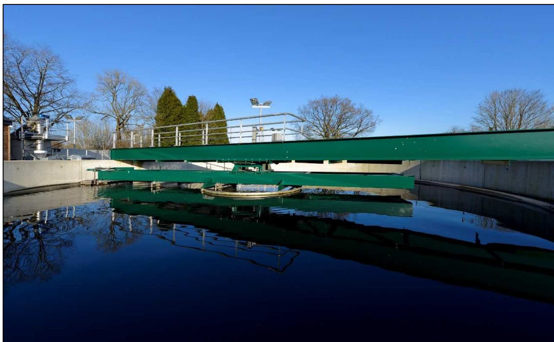
Clarificateur avec pont à entraînement central
