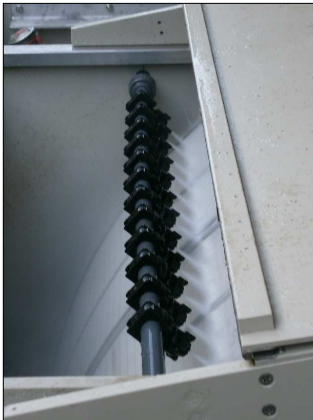
Buses de lavage du filtre
