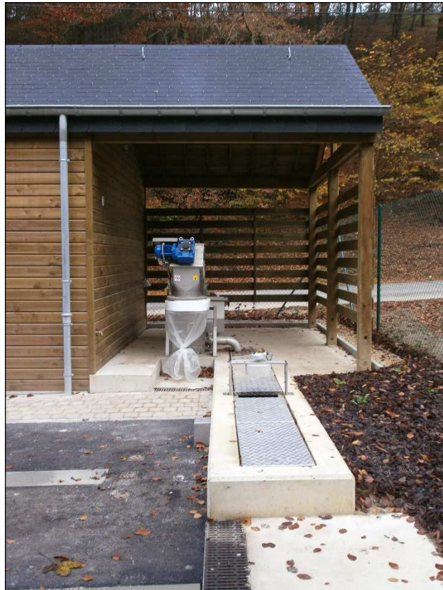
Dégrillage et canal déssableur
