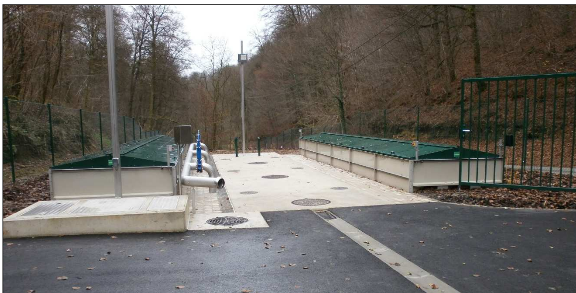
Décanteur-digesteur et modules préfabriqués des biodisques
