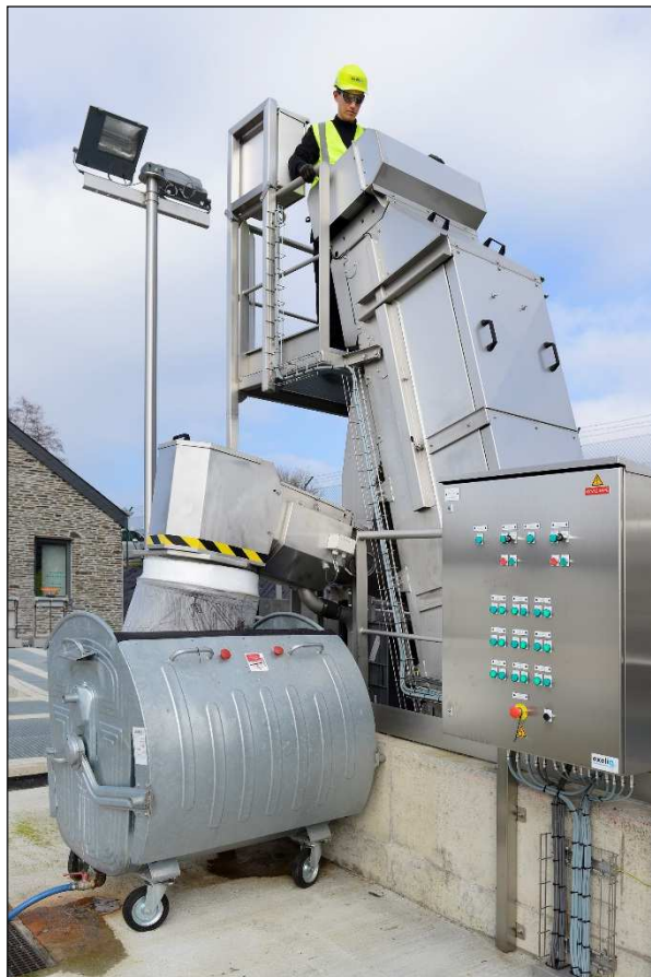
Dégrilleur automatique à grappin avec conteneur de stockage des déchets
