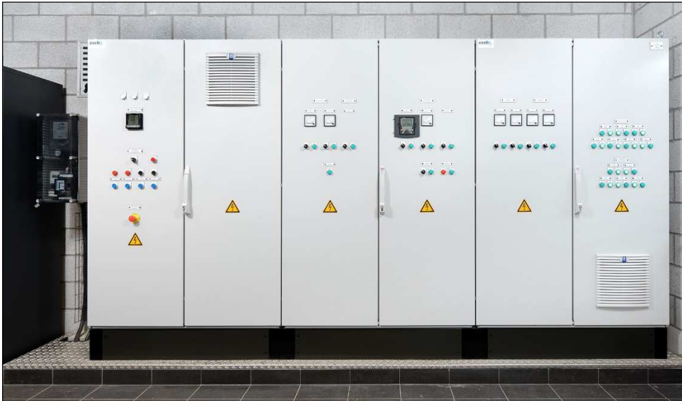
TGBT installé dans le bâtiment d'exploitation
