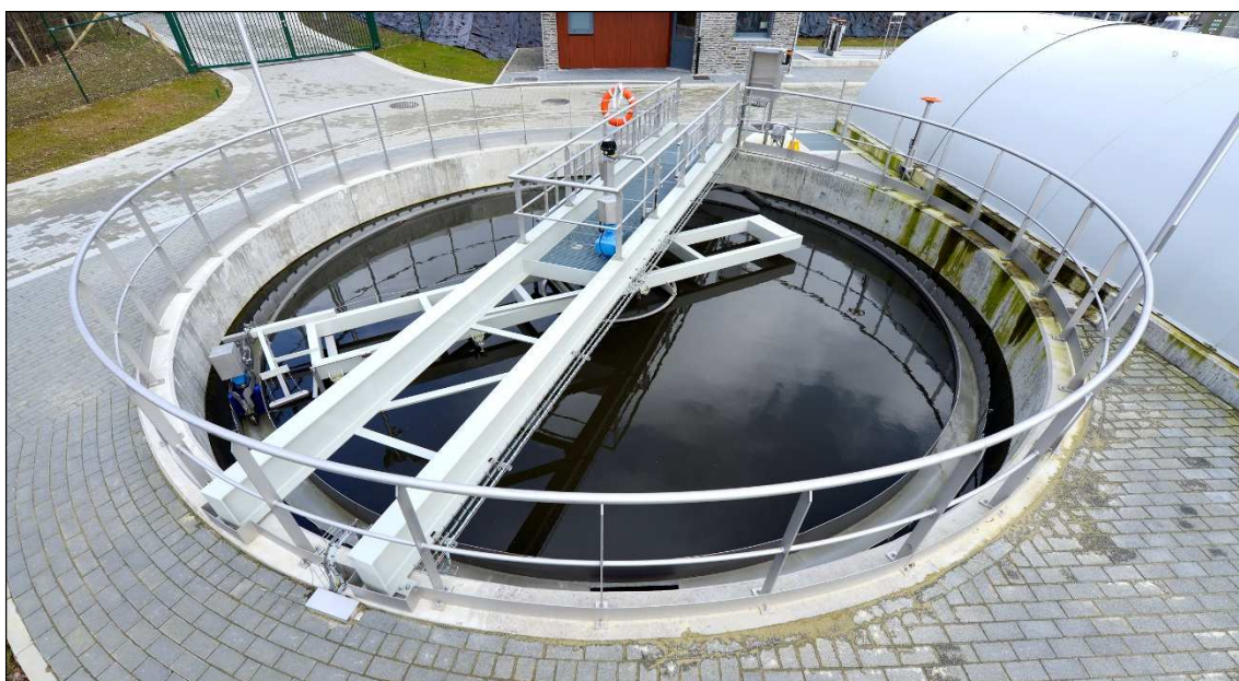
Clarificateur avec pont racler à entraînement central et raclage radial et brosse motorisée
