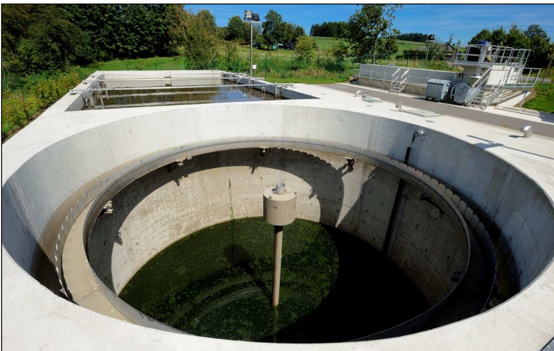
Buses de lavage du filtre
