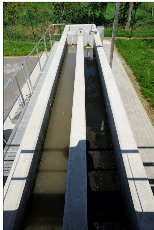
Double désableur – répartiteur de débit
