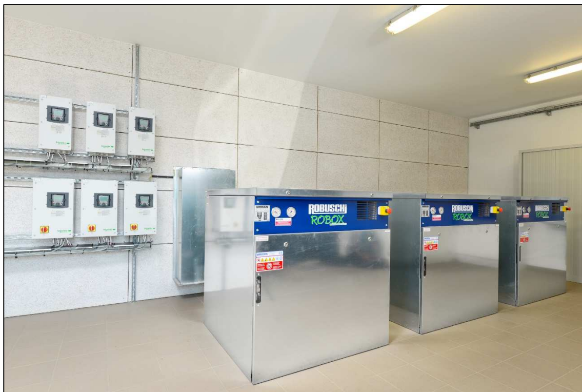
Surpresseurs d'aération et variateurs de fréquence
