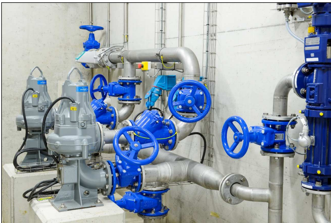
Pompe de recirculation en cave sèche
