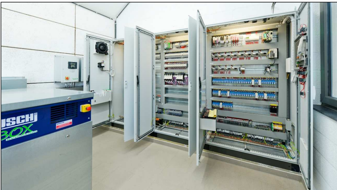
TGBT dans le bâtiment
