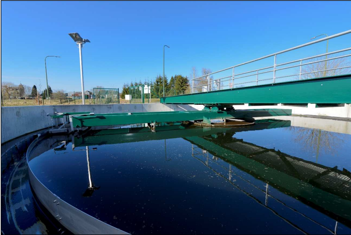
Clarificateur avec pont à entraînement central
