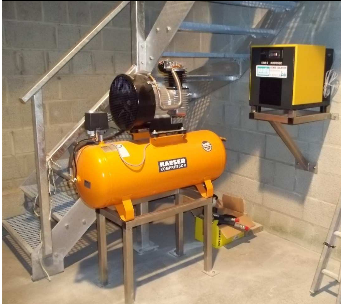
Unité de production d'air comprimé sec
