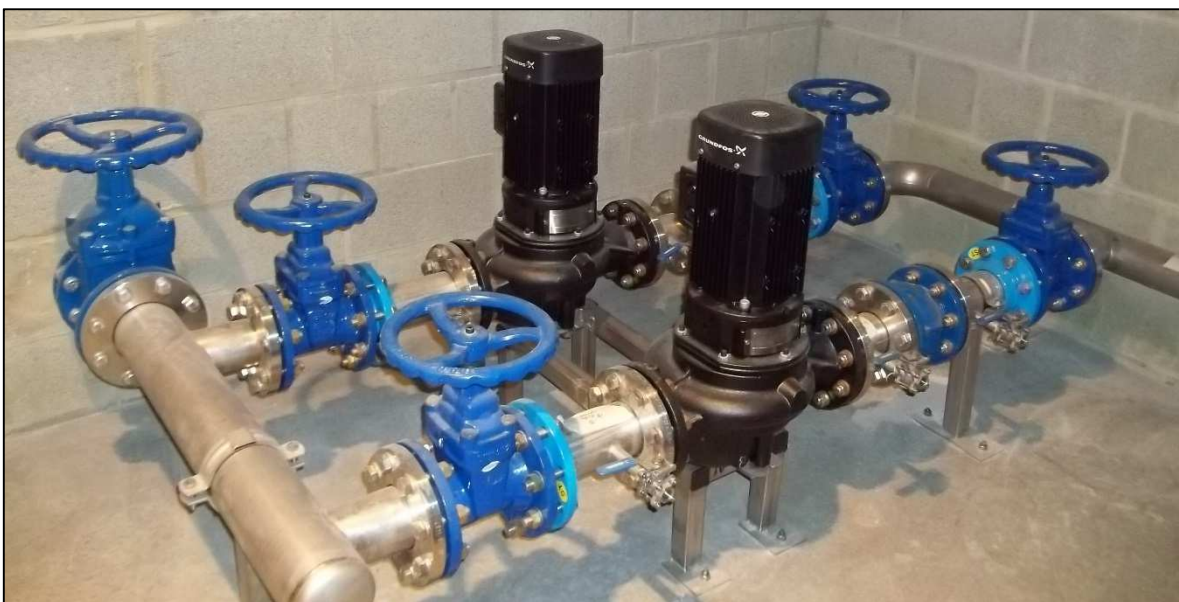
Pompes de lavage (vers filtre)
