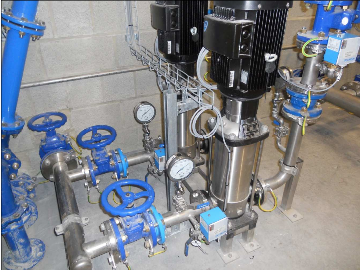
Pompes de reprise (vers filtre et stockage)
