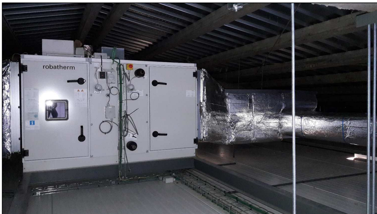
Groupe de pulsion sur sa structure suspendue
