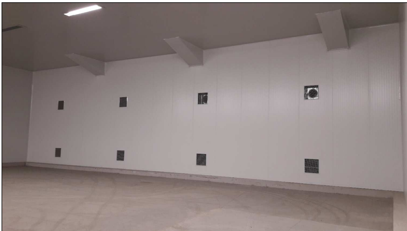
Vue intérieure de la chambre et des gaines de reprise d'air
