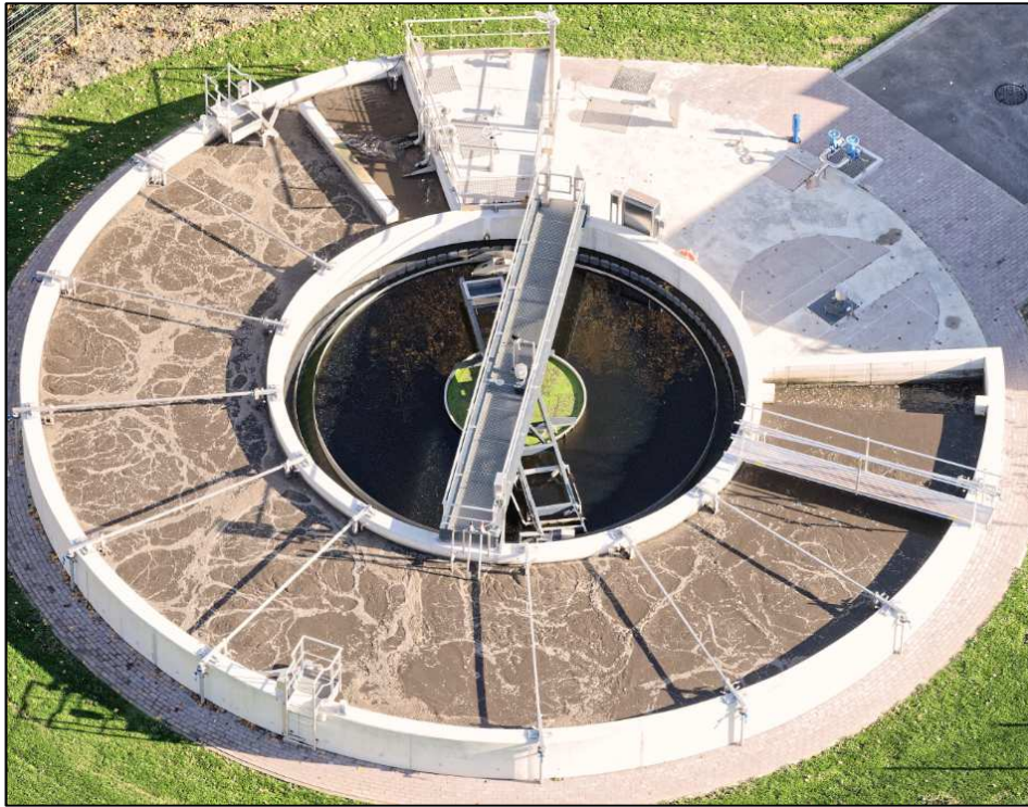
Vue aérienne du bassin biologique et du clarificateur central
