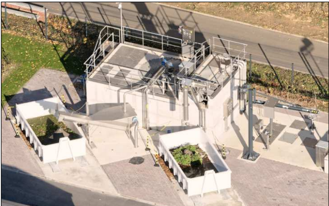
Vue générale du prétraitement (dégrilleur à tamis – déssableur cylindro-conique)
