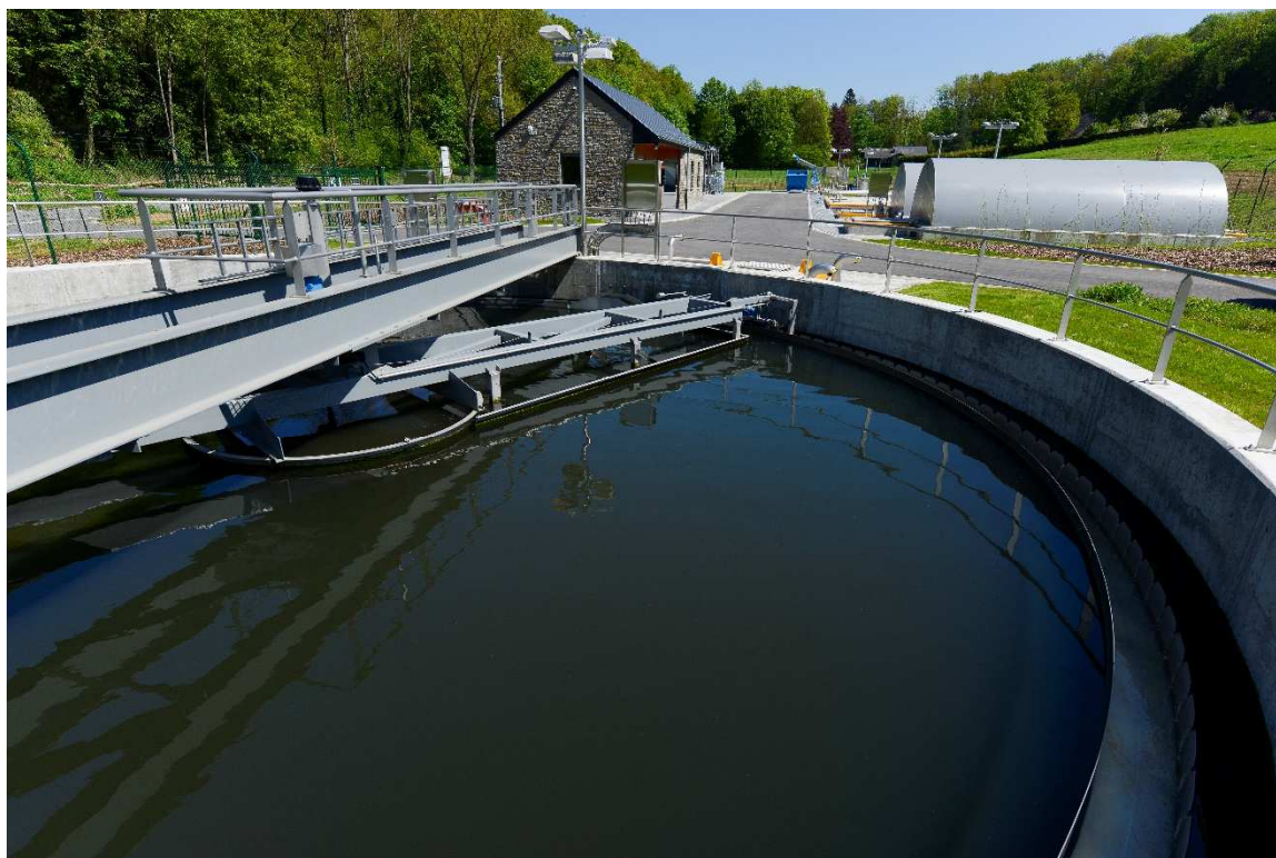
Clarificateur avec pont racleur à entraînement central et raclage radial
