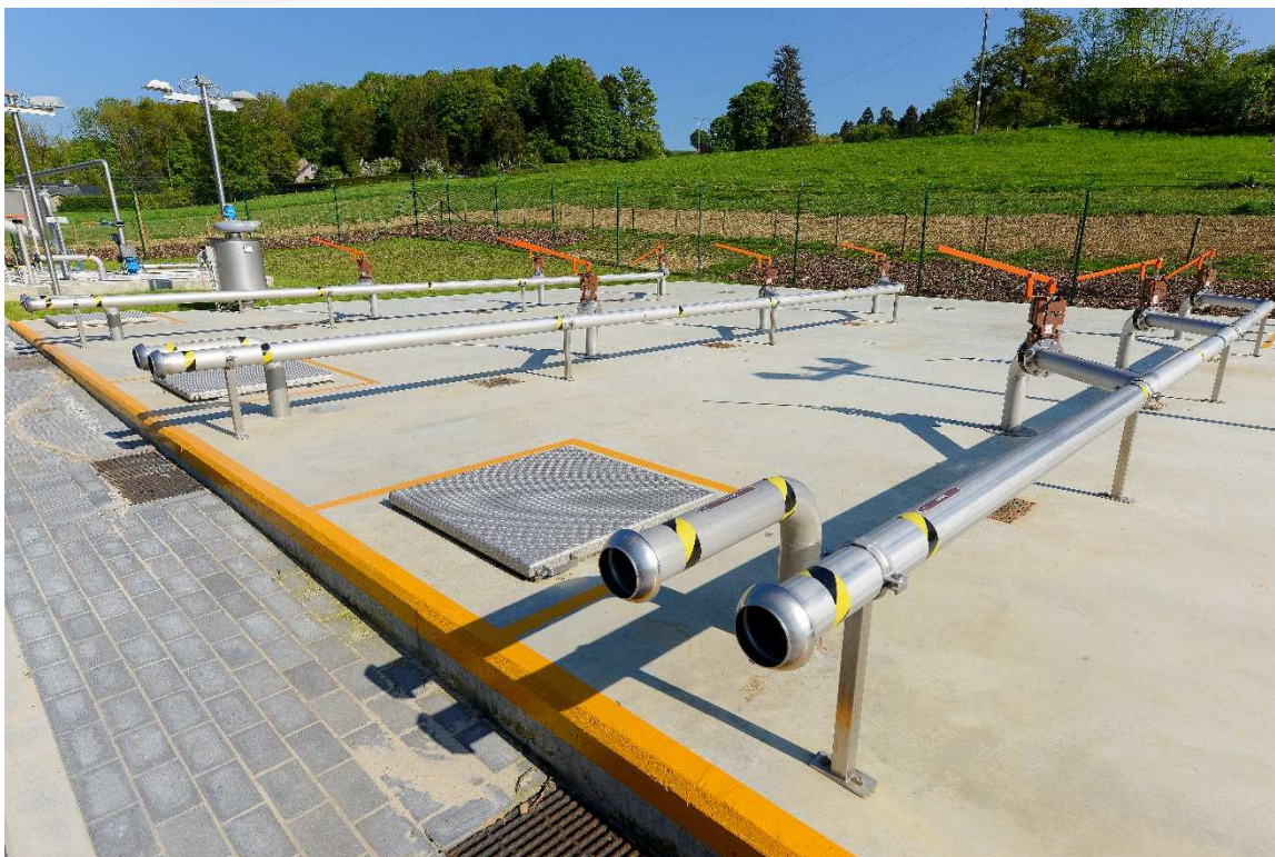
Réseau de pompage
