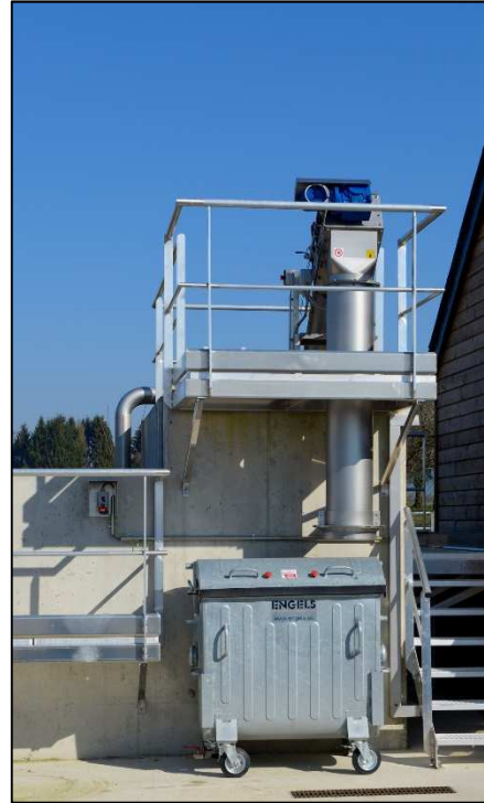
Stockage des déchets du dégrilleur
