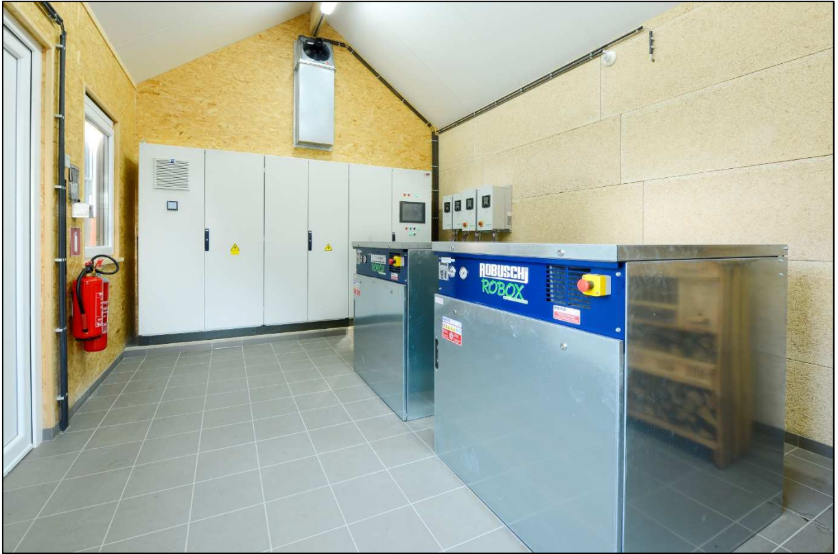
TGBT et surpresseurs dans le bâtiment
