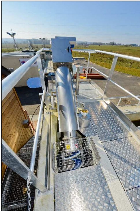
Dégrilleur-compacteur à vis
